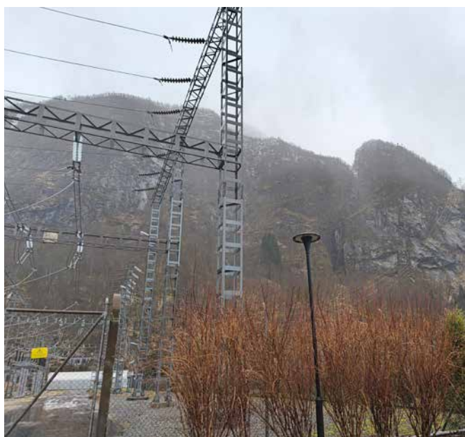
Linjebygging i norsk natur er dyrt. Dette er fra Matre i Vestland fylke. Foto: Kjell Magne Opheim
